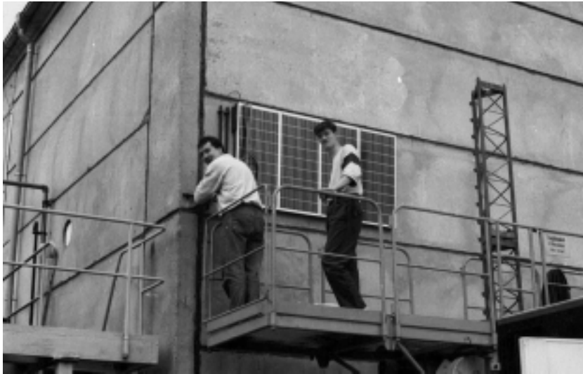
Bild 2: Installation der ersten PV-Anlage im Altlandkreis Köthen im Jahre 1992
