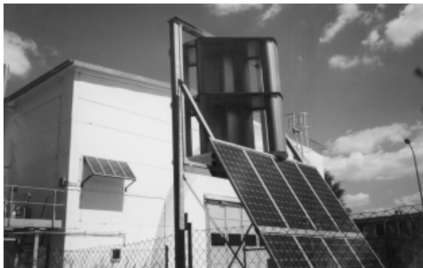
Bild 4: 1,3 kWp-PV/Wind-Anlage mit Netzeinspeisung im Vordergrund
